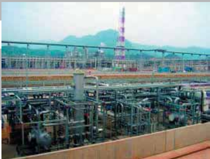
Sistema de recuperação de vapores em usina petroquímica
